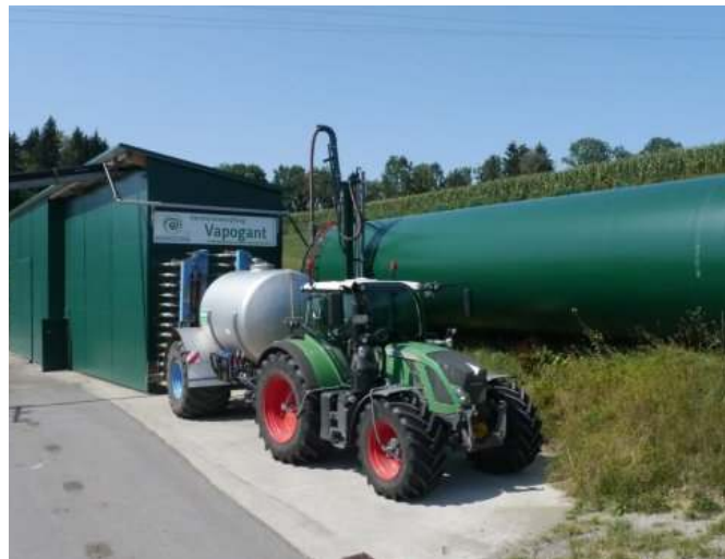
Cuve de stockage de la solution de sulfate d'ammonium en sortie de l'évaporateur pour épandage ou commercialisation ultérieure, photo Biogastechnik Süd
