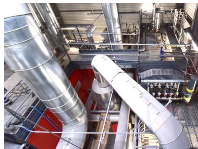
Vue générale des chaudières bois de Saint-Affrique, photo FD
