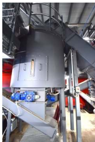
Système de dosage du bois dans les chaudières Uniconfort de Saint-Affrique, photo FD
