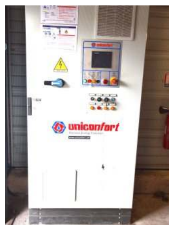
Armoire de commandes de l'une des deux chaudières Uniconfort à Saint-Affrique, photo FD
