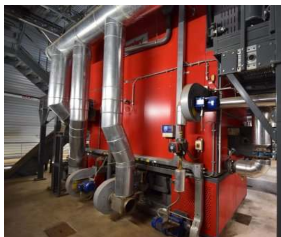
Vue du niveau foyer de la petite chaudière de la chaufferie de Saint-Affrique, photo FD
